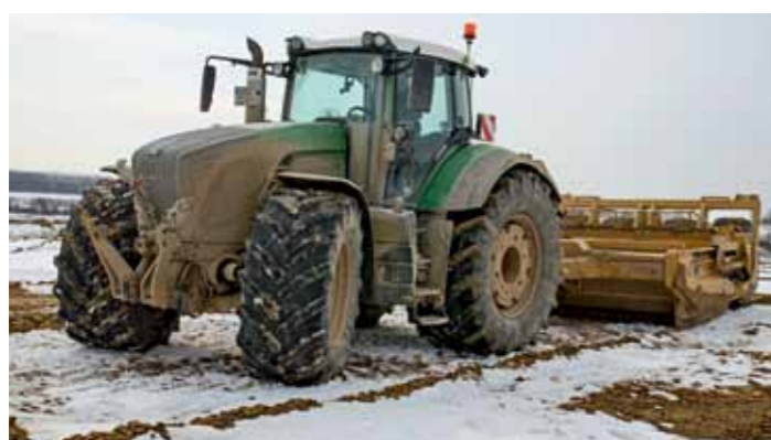
Mit dem Schürfkübel wird Erde abgetragen, um an die darunterliegende Sandschicht zu gelangen.
