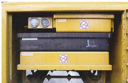
In dieser Box stecken die Controller für die Bremse und die beiden hinteren Radmotoren.
